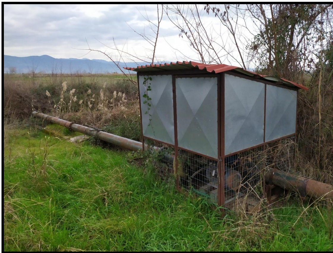
Φωτογραφία 1: Υφιστάμενο αντλιοστάσιο στο Ποταμό Σπερχειό
